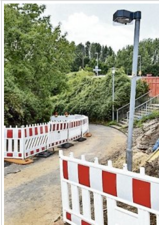
Für viele Bahnkunden ein Ärgernis: Die Rampe zur Unterführung am Bahnhof Rethen. Junker
